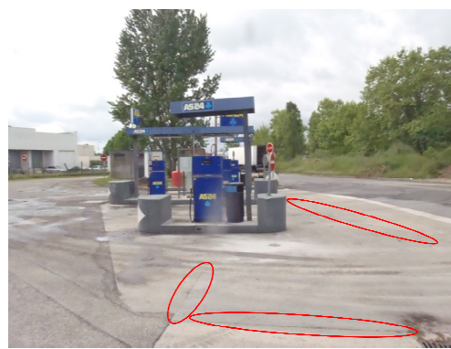
Photographie 4 : Vue sur des fissurations de la dalle béton au droit des pistes de distribution
