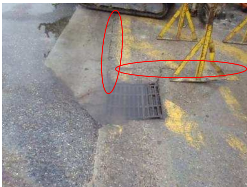
Photographie 3 : Vue sur une fracture de la dalle béton au droit de l'aire de dépotage et d'un débordement du réseau d'eaux pluviales
